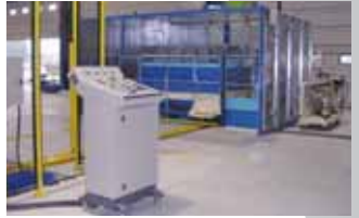
Control cabinet Poste de commande
